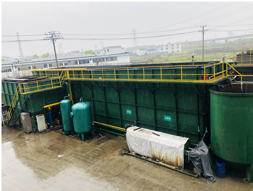
图 3-2 废水处理设施
